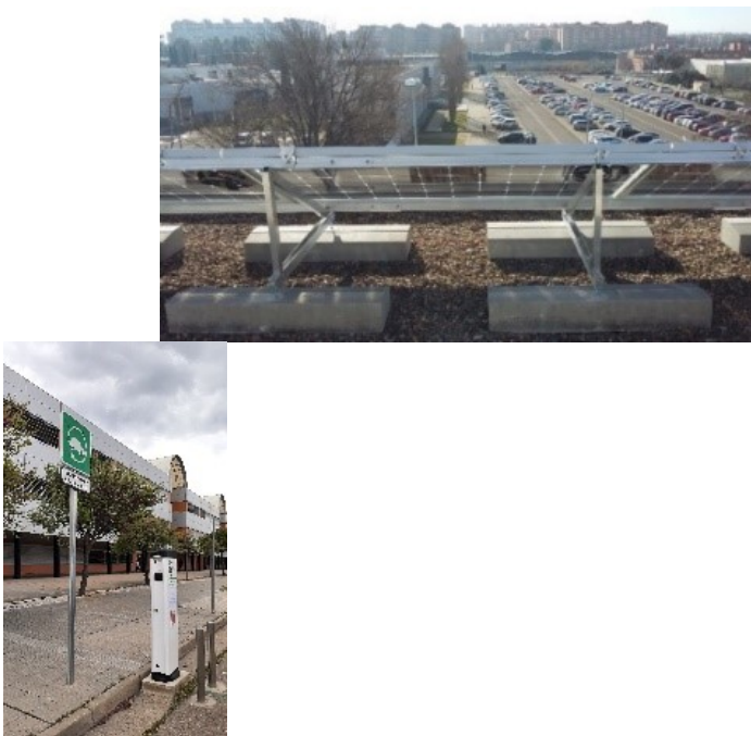
Figura 7.- Fotografías Placas fotovoltaicas en la cubierta del Torres Quevedo y cargador para vehículos eléctricos.
